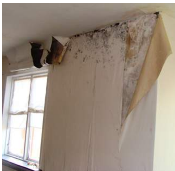
Omfattende fugtskade og skimmelsvampevækst
