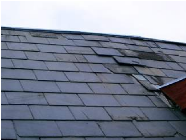
Manglende vedligeholdelse med vandindtrængen
