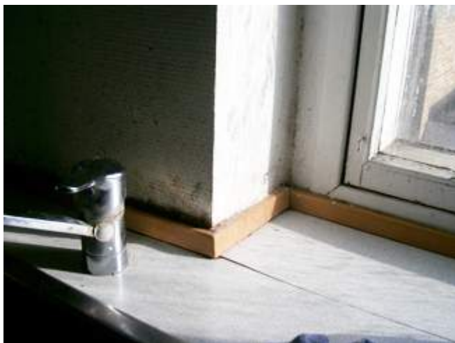
Fugt og skimmelsvampevækst i et køkken
