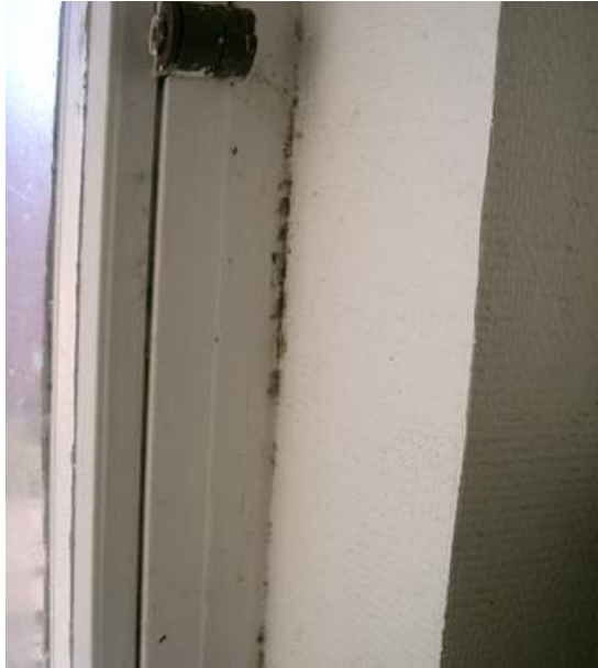
Kuldebro med fugt og skimmelvækst
