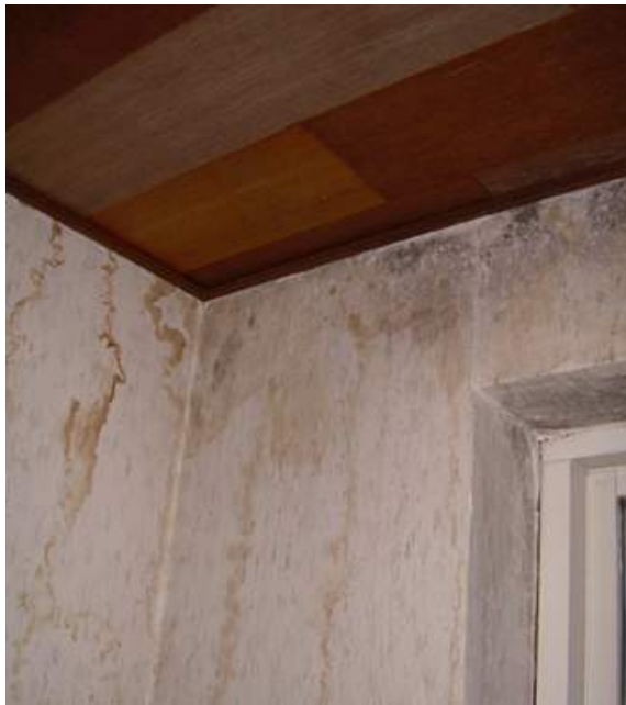
Omfattende fugtskader og skimmelsvampevækst
