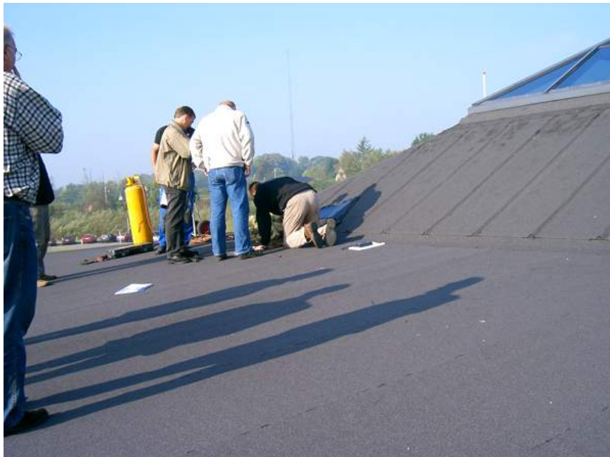
Forskellige aktører i færd med at undersøge skimmelsvampeskade.
