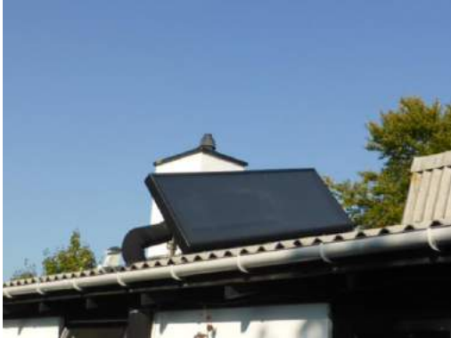
Inaktiv solfanger på tag med rørføring til kælderen.
