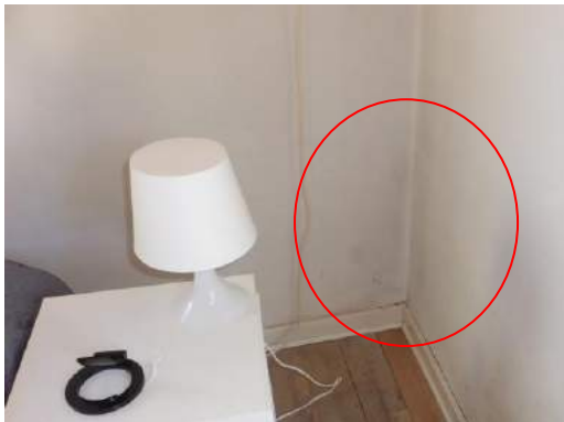
Hjørne i soveværelse hvor der kommer sortsværtning/skimmel.
