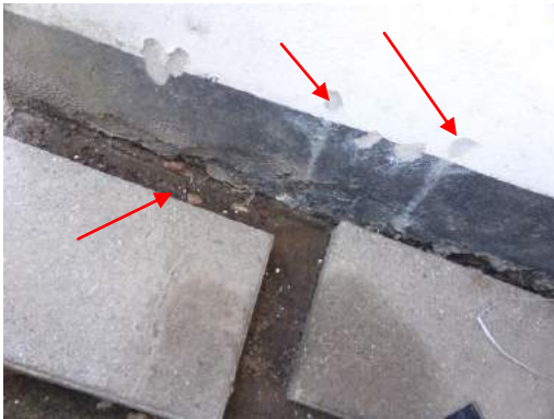
Nordlig gavl med fugtigt jord under betonfliser. og spor efter forsøg med Vandglas.
