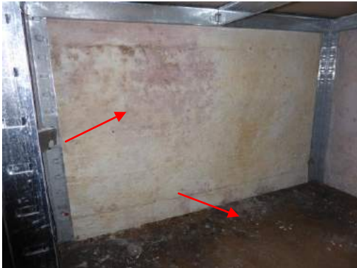
Kældervæg og reol med træhylde, med skimmel.
