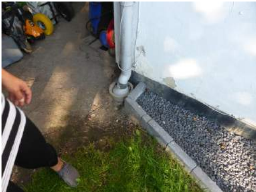
Nordvestligt hjørne hvor der er meget fugtigt i kælderen.
